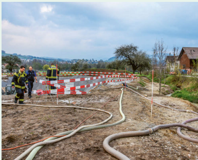
Abtwil (SG): Von einer Baustelle gelangte im April 2017 verschmutztes Abwasser in den Mülibach, über 100 Fische verendeten.
