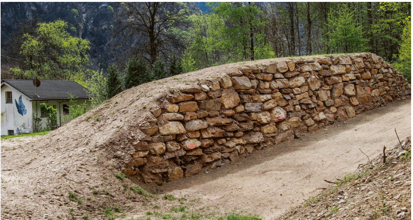
Steinschlagschutzdamm in Soazza (TI)
